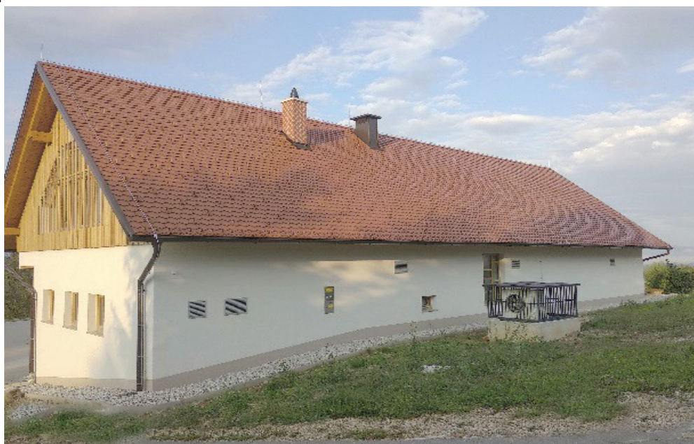
Strelovodna napeljava z lovilci na severni in jugovzhodni strani objekta, nameščeno v maju 2018
