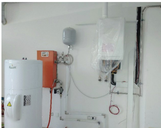
Ogrevalni prostor – strojnica, junij 2018
